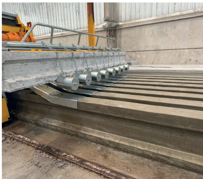
Vigas I fabricadas con la máquina deslizante de Nordimpianti
